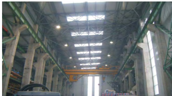
秦皇岛首秦龙汇矿业照明工程
